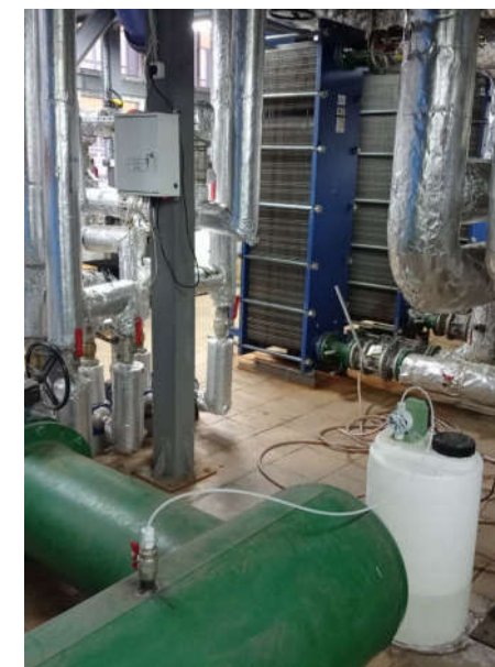
Фото встановленого обладнання
